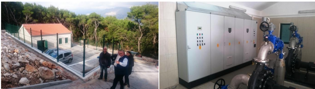
Procrpna stanica Česminova vala, investitor: Vodovod Brač d.o.o., Supetar
